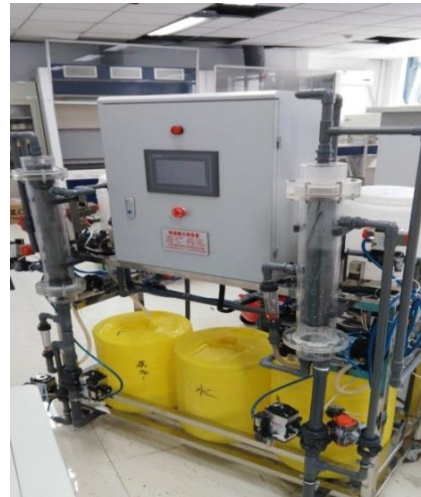
图2 海洋资源开发利用实验室工程 设备-固液膜分离工艺流程设备
